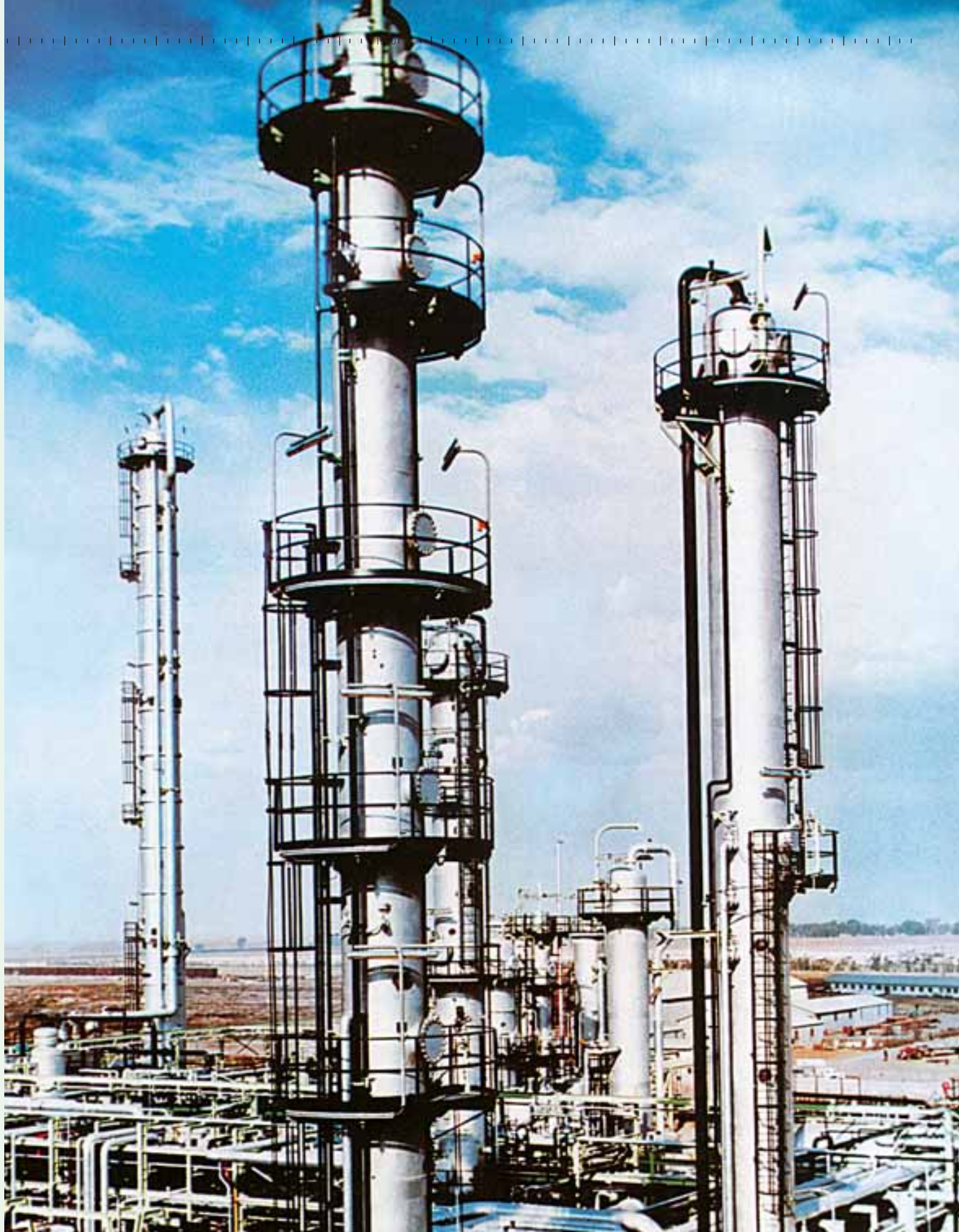
Teilsicht einer von Linde erbauten Petrochemieanlage in Südafrika.
