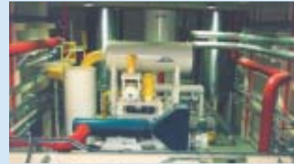
Unten Abb. 10: VPSA-Anlage mit einer Kapazität von 1.600 m 3 /h O 2
