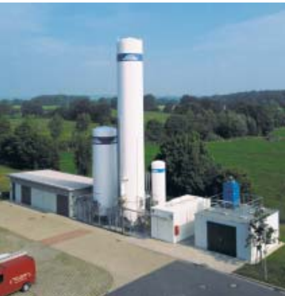
Abb. 6: Kryogene N 2 -Anlage für 620 Nm 3 /h Stickstoff
