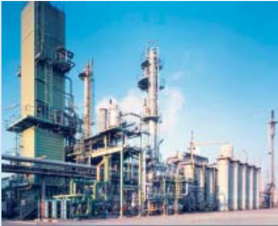
Abb. 5: Kältetechnische Gastrennungs- anlage
