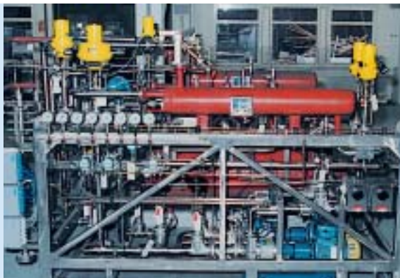
Abb. 2: Kryogenes Temperatursystem ohne Isolation für eine Reaktorkühlung
