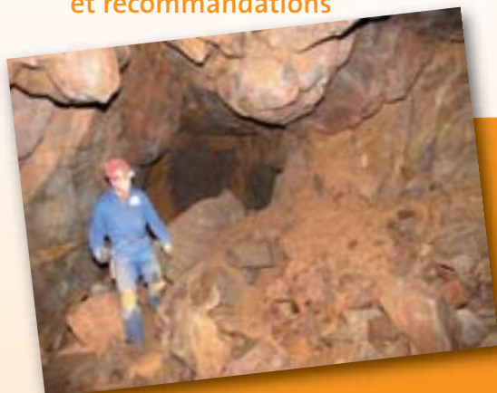
Chute de toit (dièdre) dans la première chambre du Rorhrburg (source : C. Mathon)
