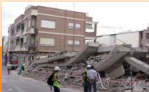
Effondrement en « pancake » d'un immeuble collectif récent, par rupture des poteaux courts s'adaptant à la pente du terrain
