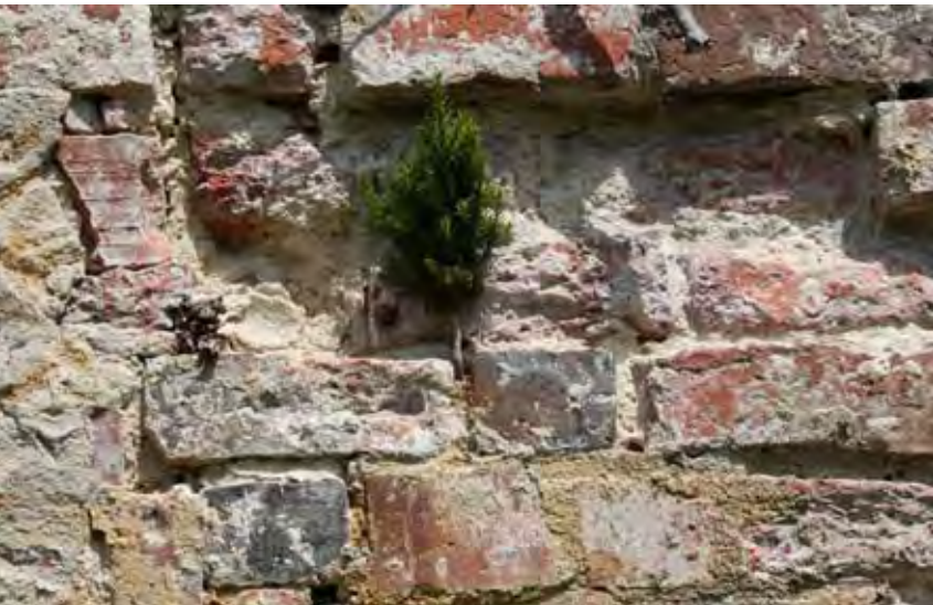
▲ Typisches Schadensbild des Mauerwerks
