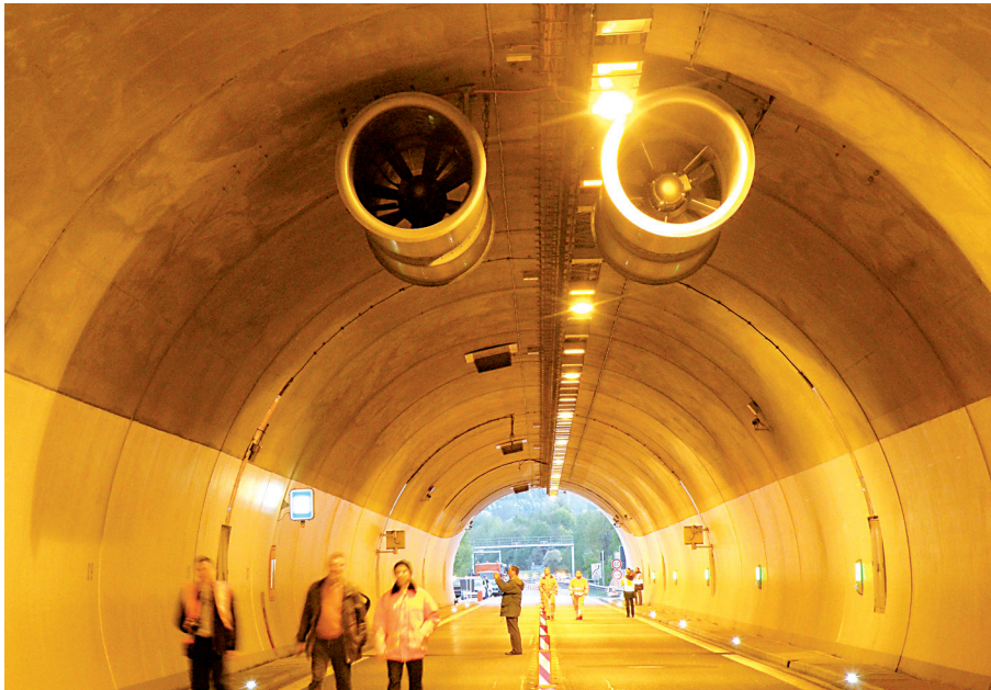
Synchronisierte Längsbeschallung mit drei hintereinanderliegenden Lautsprechern an der Decke (Bild: Christof Sistenich, BAST)
