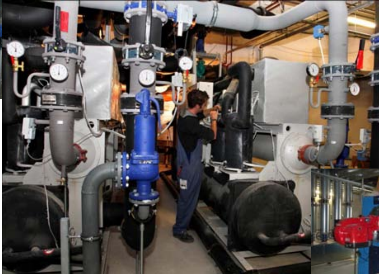
2 Wärmepumpen á 640 kW
