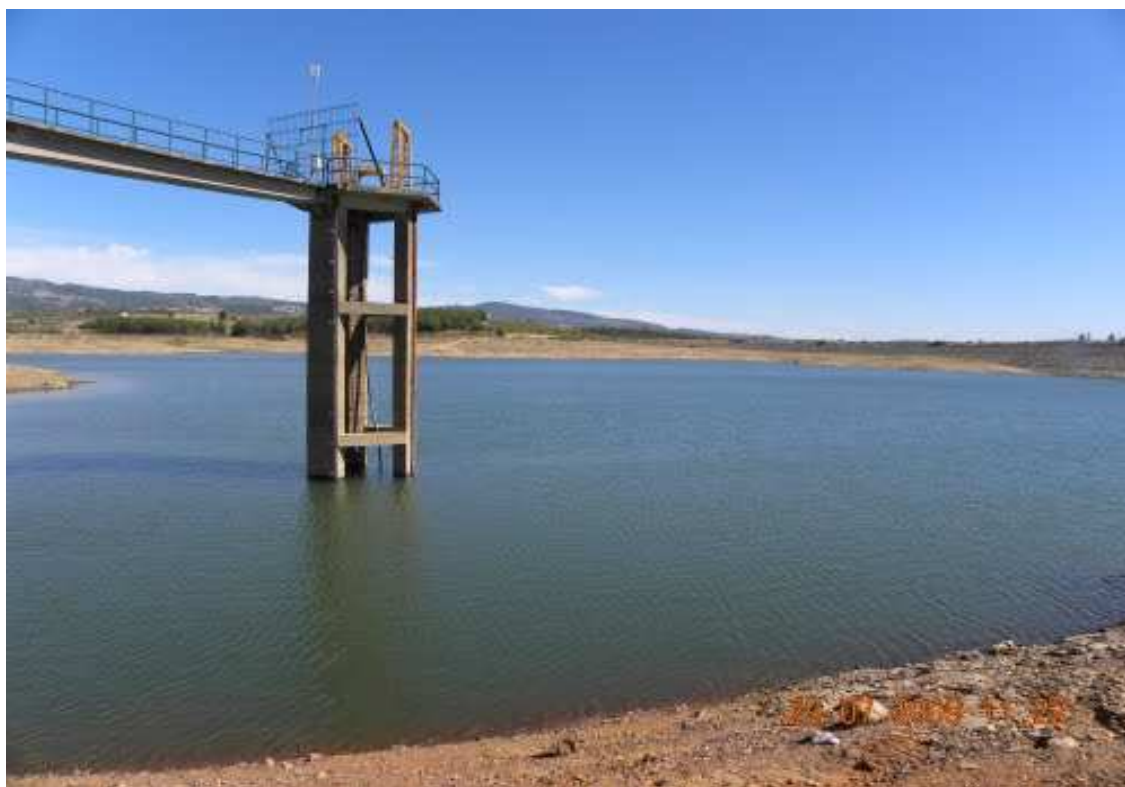
TOMADA DE ÁGUA
