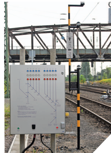
Der EOW-Bereich von BBR im Güterbahnhof Offenbach
