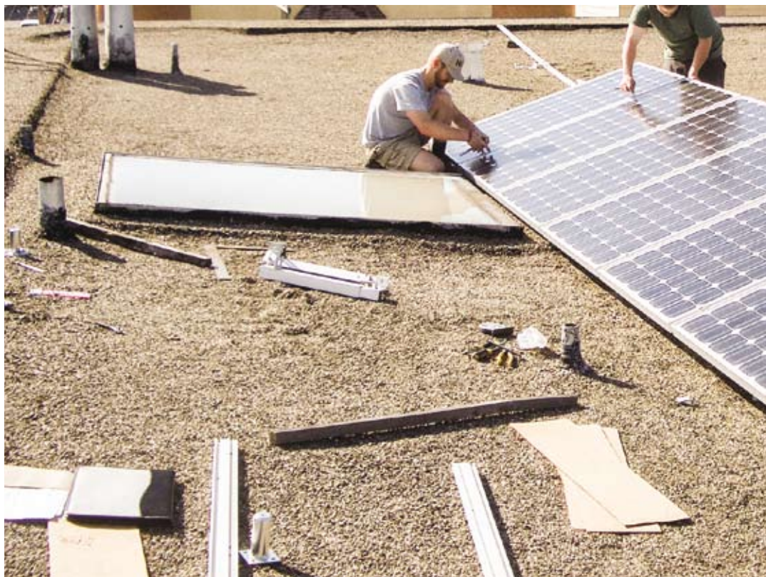
PV-Installation auf einem Hausdach in San Francisco. Foto: Brian Kusler, www.flickr.com
