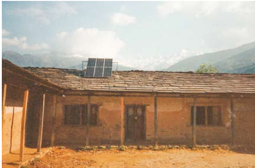
Die frisch installierte PV-Anlage auf dem Schuldach. – Alle Abbildungen stammen, soweit nicht anders vermerkt, aus dem Fotoalbum, das Eckard Quitman 1994 von seiner Nepalreise anfertigte.
