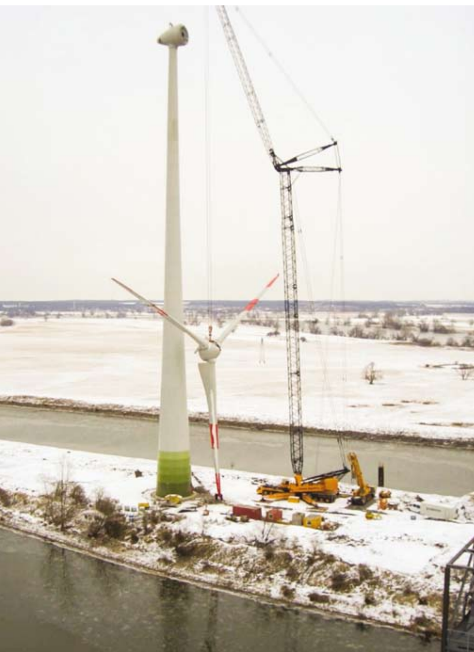
Enercon E 70 Windkraftanlage (ca. 2 MW) bei Magdeburg (2005). Foto: Hadhuey.
