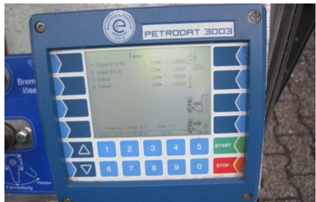
Blick in den Messanlagenschrank
