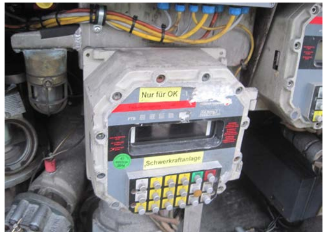
Blick in den Messanlagenschrank
