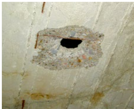
Freigelegt: Bauliche Mängel im Saalboden
