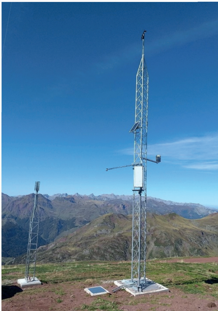
Estación automática de alta montaña en Astún-La Raca.
