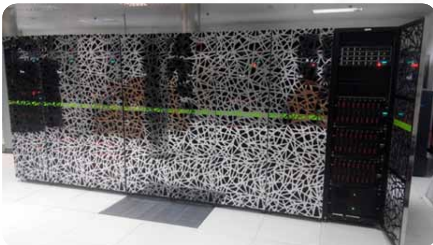
Nuevo superordenador instalado en los servicios centrales de AEMET
