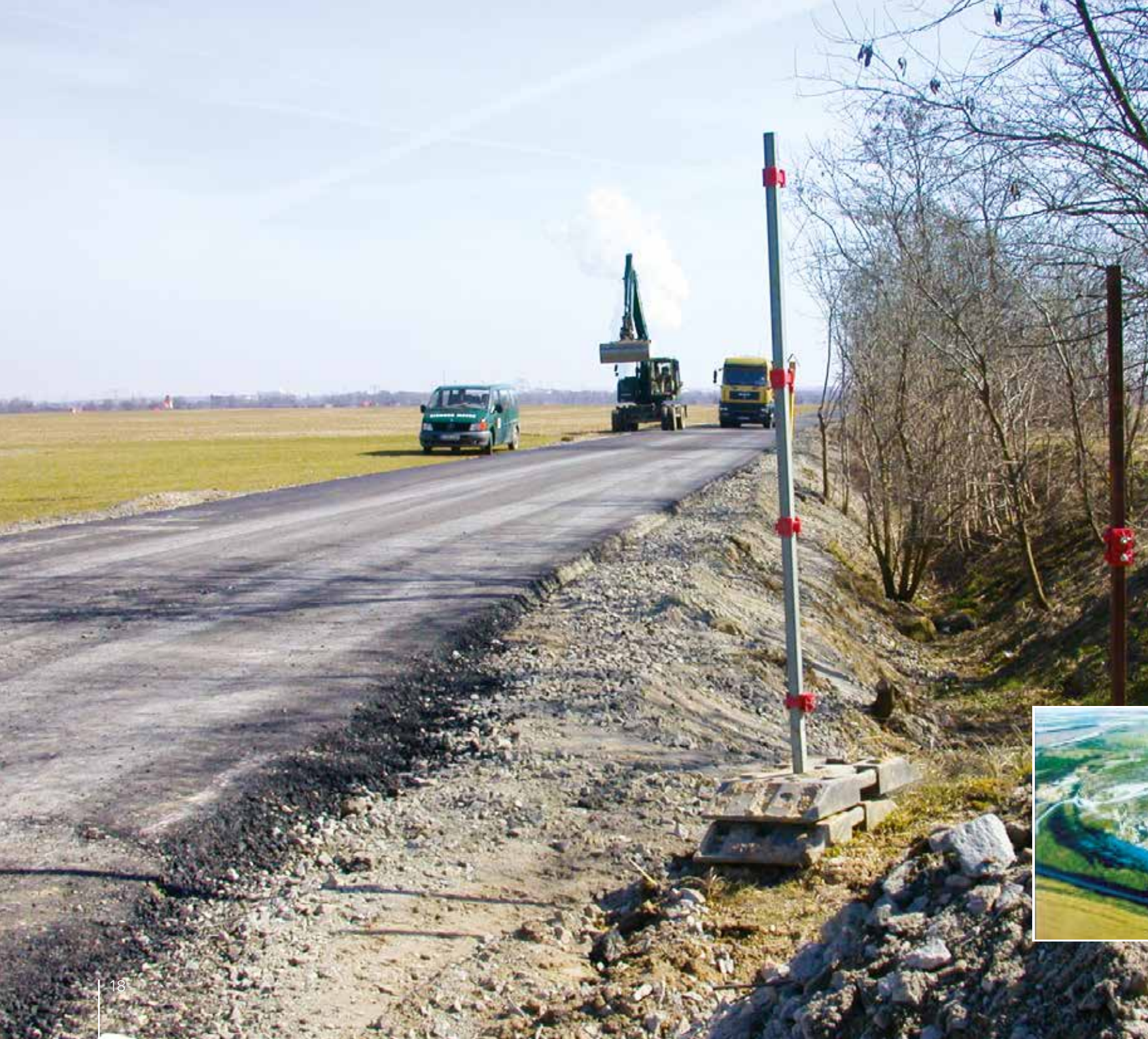
Wegebau im Bereich des Zauschwitzer Weges auf der Altkippe Profen westlich von Pegau, 2010
