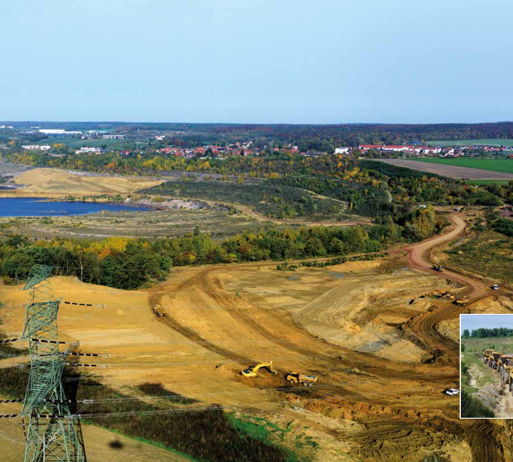
Massengewinnung in der Trasse des zukünftigen Verlaufs des Harbker Mühlbachs (im Vordergrund) zur Anstützung der Ostböschung vor der Ortslage Harbke (im Hintergrund)
