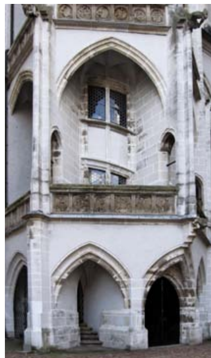
102 | Großer Wendelstein vor der Sanierung
