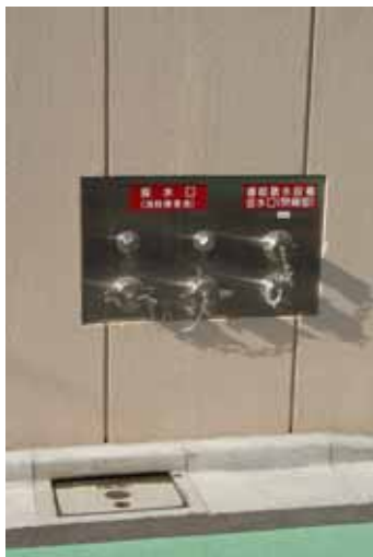
屋上プールの水を消火に使用できる消防用採水口
