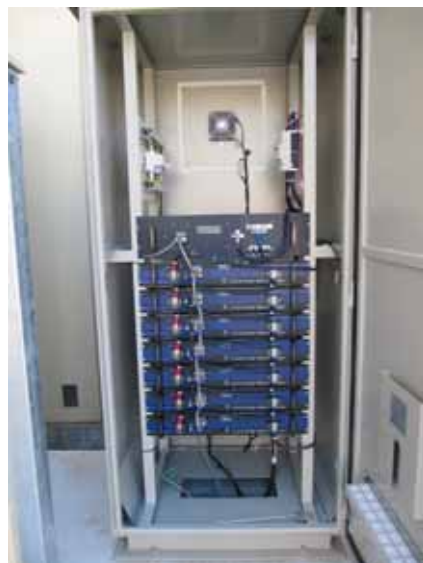
太陽光パネルで発電した電力を受電できる蓄電池
