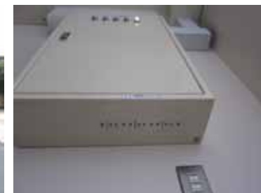
電源の自動切替え機能を持ち、下部から電源の取り出しができる電源切替盤
