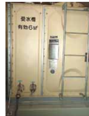
水を取り出せる水栓を備えた受水槽
