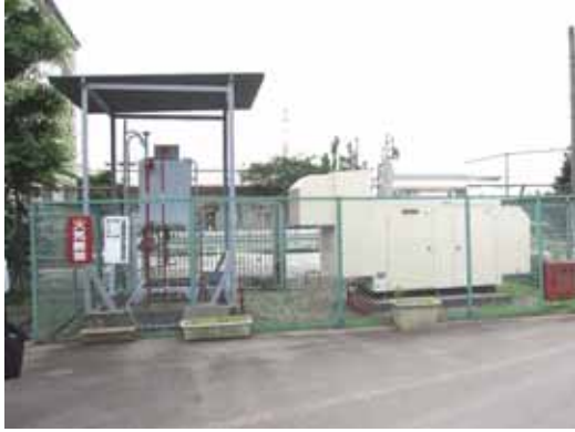
自家用発電設備(150kVA)、500Lの燃料小出槽、5,000Lの地下タンク貯蔵所により、48時間分の電源を確保。
