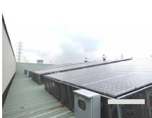
屋上の太陽光パネル(発電容量30kW)。建物の内外に発電量パネルを掲示。
