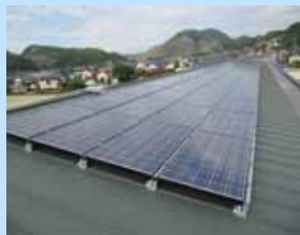
太陽光パネル
