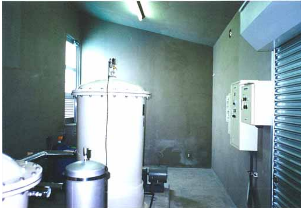
プールの水を飲料水や生活用水として利用できる緊急用給水システム
