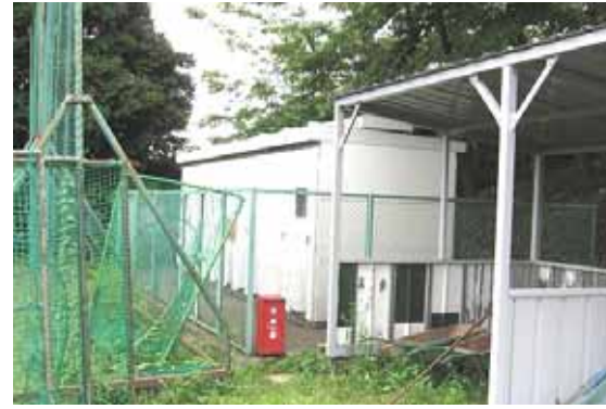
蓄電池設備(1,000Ah)により、48時間分の電源を確保。(一部の学校に設置)
