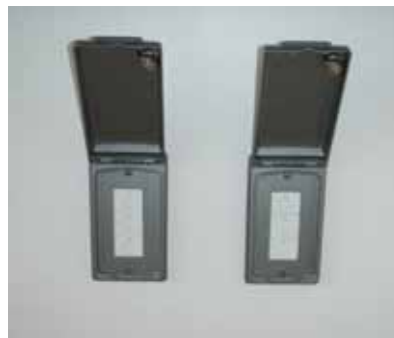
一般の電話回線が混雑しても優先的に使用できる特設公衆電話用ジャック
