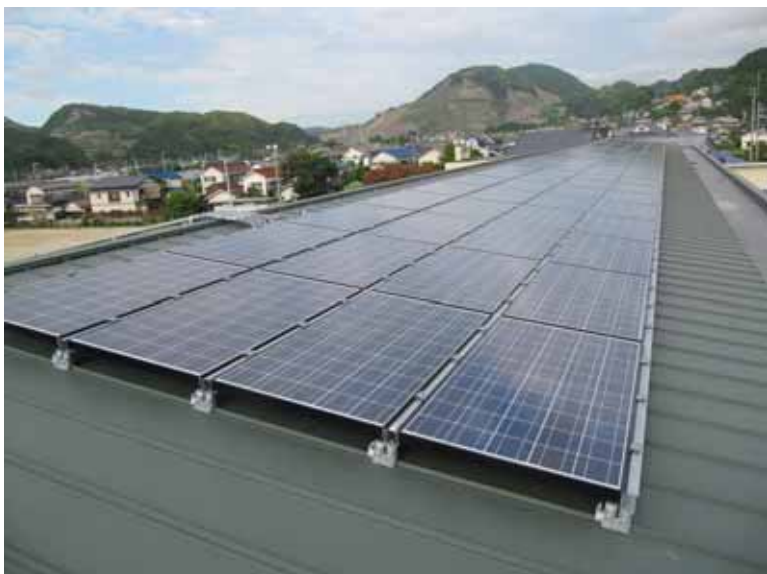
停電時でも発電できる自立運転機能を持った太陽光発電設備
