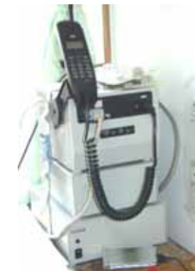
区の災害対策本部と連絡を行う防災無線
