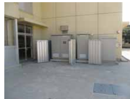
パワーコンディショナーと蓄電池盤
