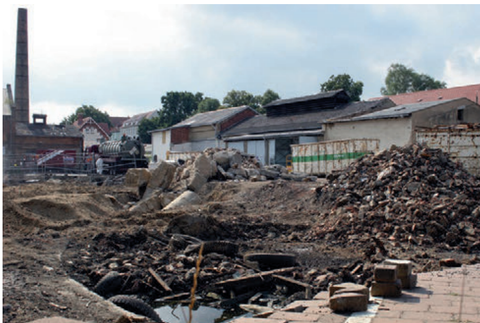
Auf dem zukünftigen Sportplatzgelände befand sich einst das städtische Gaswerk. Bei der Gasgewinnung fielen Teer und Ammoniumverbindungen an, so dass eine umfangreiche Altlastensanierung notwendig ist.
