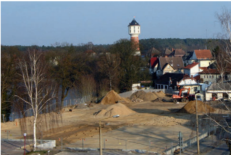
Frühling 2007: Der Bau des eigentlichen Sportplatzes beginnt. Die Spielfelder sind abgesteckt, die Flächen sind planiert.
