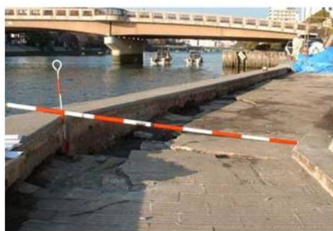
空洞化による天端の陥没(市内派川)
