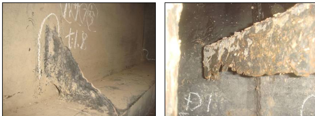
図 3-5-6 祇園水門内損傷状況
