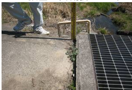
(小段天端の沈下)
