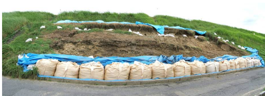
図 3-4-1 堤防のり面の損傷事例（対策済）
