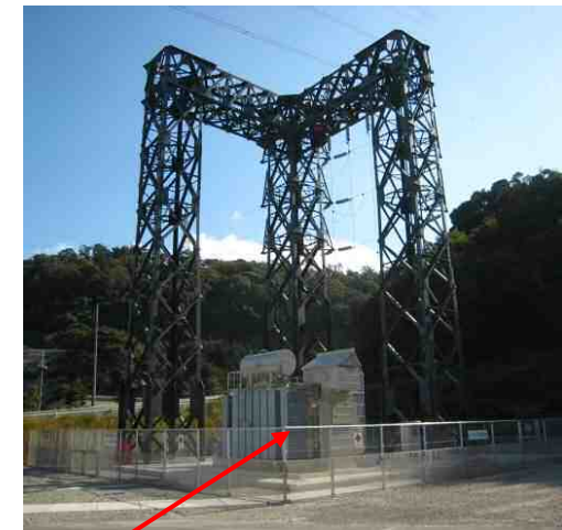
66kV受電設備
