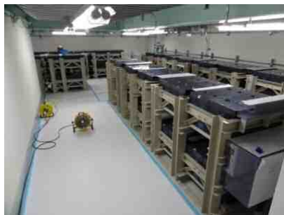
蓄電池 (追加設置)
