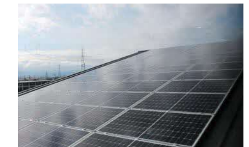
⑬太陽光パネル (屋根上部) 自然エネルギーで建物の電気を補い 省エネルギー化をはかります
