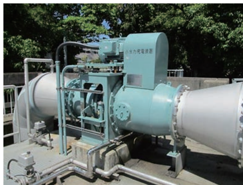
小水力発電設備（石田水環境保全センター） 定格出力：9 kW 発電実績：81,480 kWh（令和元年度）
