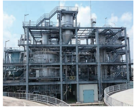
流動床式焼却炉(鳥羽水環境保全センター)
