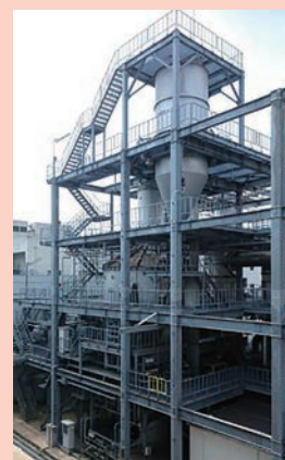
流動床式焼却炉 (鳥羽水環境保全センター)
