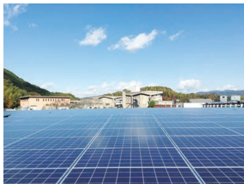
太陽光発電設備（新山科浄水場）
