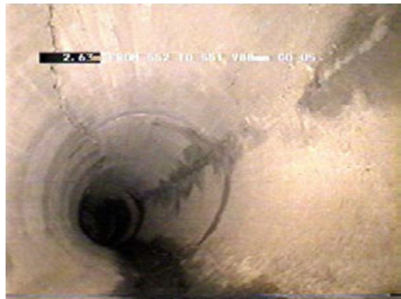
Plate F4 Longitudinal Fracture
