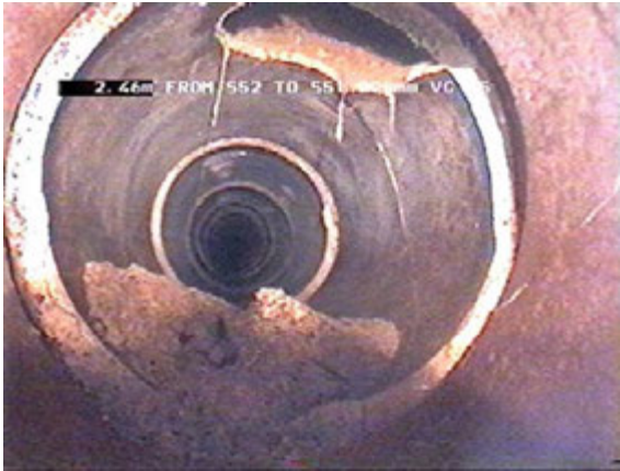
Plate F1 Missing Piece of Pipe Wall
