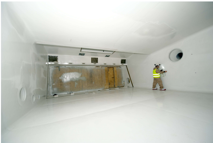
Abbildung 15: Saugrohr mit Nische für die Saugrohrklappe (Foto: SEO).
