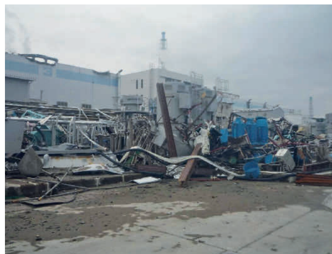
Abb. 3.13: Blick auf das Turbinenhaus von Block 3 (links im Hintergrund) nach dem Tsunami (Quelle: TEPCO).
