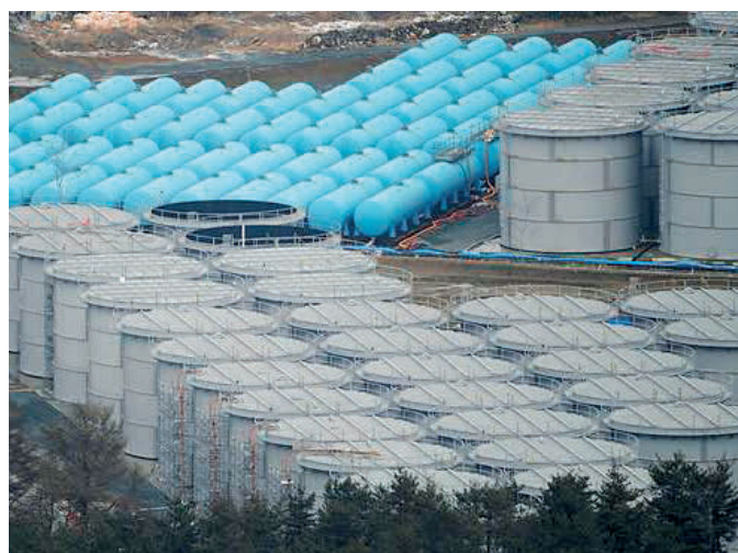
Abb. 6.9: Tanks auf dem Anlagengelände (Quelle TEPCO).
