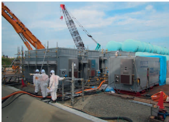
Abb. 6.6: Mobile Strontium-Reinigungsanlagen neben Tanks zur Zwischenlagerung kontaminierter Wässer (Quelle: TEPCO)
