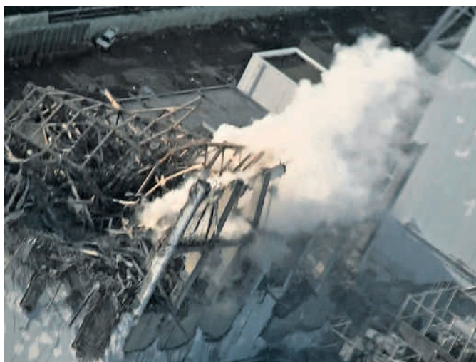
Abb. 3.25: Blick auf die Zerstörungen von Block 3 vom Hubschrauber aus (Quelle: TEPCO).
