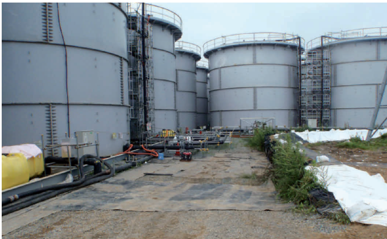
Abb. 3.35: Tanks des Aufstellungsbereichs H4, in dem sich die mit INES 3 eingestufte Leckage ereignete. Rechts im Bild ist ein aus Sandsäcken errichteter Wall zu erkennen, mit dem im Fall weiterer Leckagen eine weitere Verbreitung des kontaminierten Wassers verhindert werden soll (Quelle: TEPCO).
