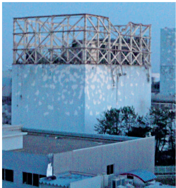
Abb. 3.14: Reaktorgebäude des Blocks 1 nach der Explosion am 12. März 2011 (Quelle: TEPCO).
