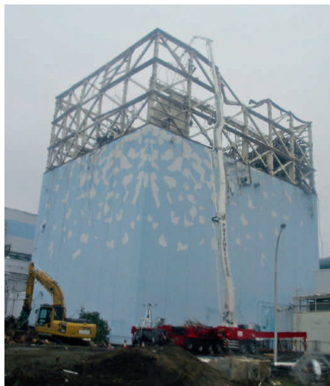
Abb. 3.15: Einspeisung von Wasser in das Brennelementlagerbecken des Blocks 1 mit einer Autobetonpumpe (Quelle: TEPCO).
