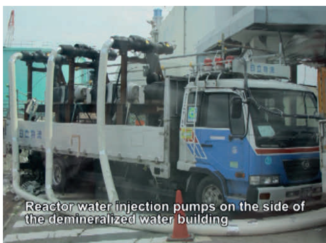
Abb. 6.1: Reaktoreinspeisepumpen und Ersatzaggregate (Quelle: TEPCO).
