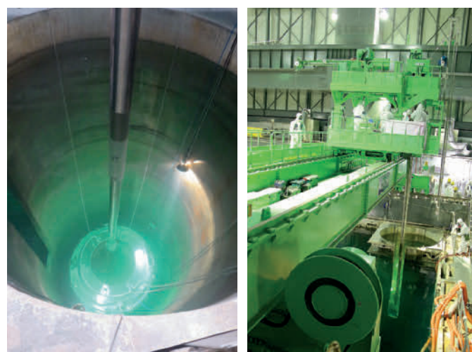
Abb. 6.26: Transportbehälter in Beladeposition (links) und Blick in die Brennelement-Wechselmaschine (rechts) (Quelle: TEPCO).
