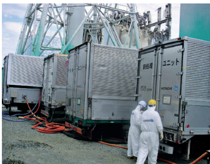
Abb. 6.4: Mobile Anlagen zur Entsalzung des Wassers in den BE-Lagerbecken (Quelle: TEPCO).
