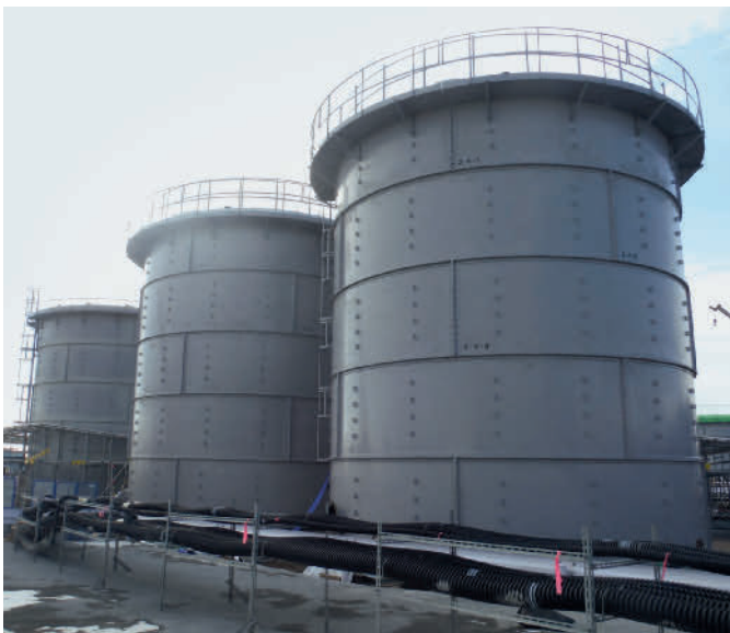
Abb. 6.12: Verschraubte Tanks mit 1.000 m 3 Volumen zur Lagerung von kontaminiertem Wasser (Quelle: TEPCO).
