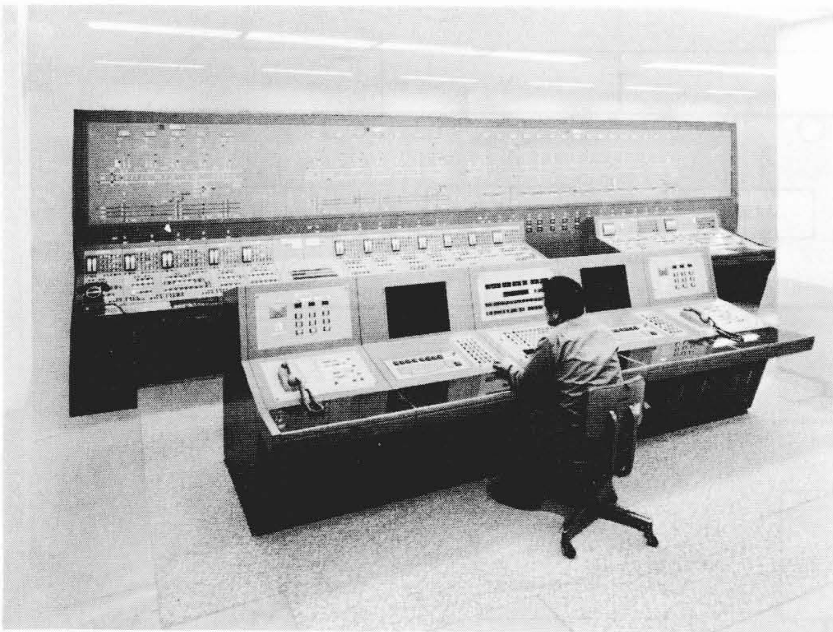
図10 東京都交通局納め電力管理システム 変電所及び開閉所機器の遠隔監視制御、記録、指令業務などを自動化し、電力管理業務の合理化と省力化を図っている。
