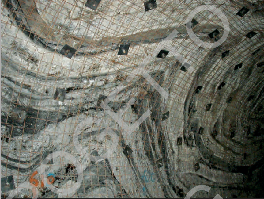
Abb. 88 – Starke Deformation im Val Vela-Kalk im Tunnel von Mezzolombardo (siehe Abb. 87 zur genauen Lage).
