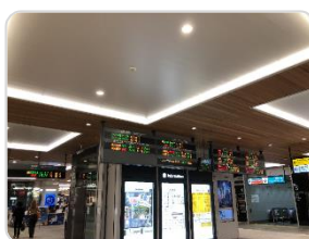
照明設備のLED化
