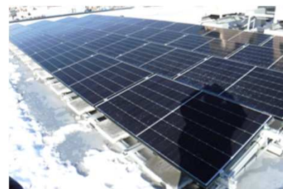
札幌交通機械 本社屋上太陽光パネル
