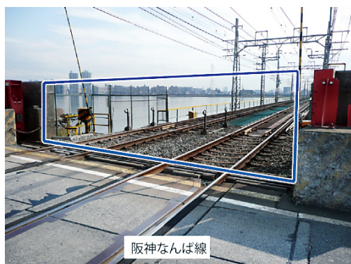
図16 橋桁を越流した津波の氾濫口
