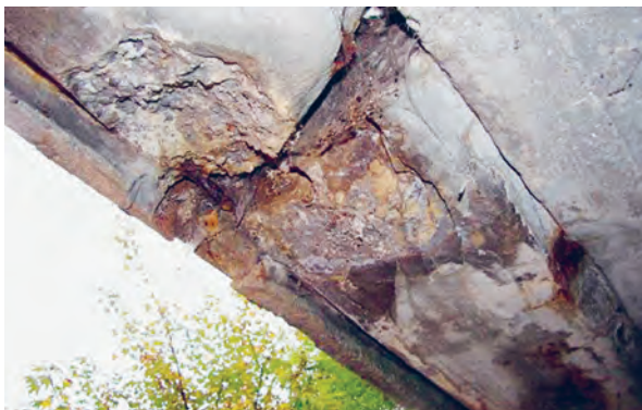
Betonabplatzungen an Kappenfuge Foto: Dr. Schütz Ingenieure
