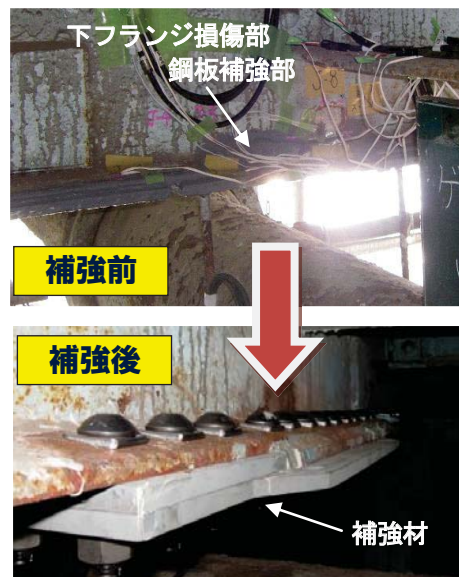
図3 補強の一例 (B8 横桁 J 部)
