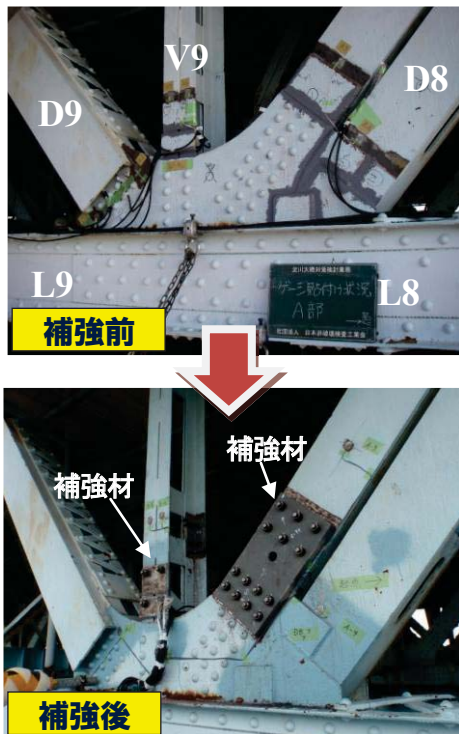
図2 補強の一例 (主構トラス G1 下流側 A 部)
