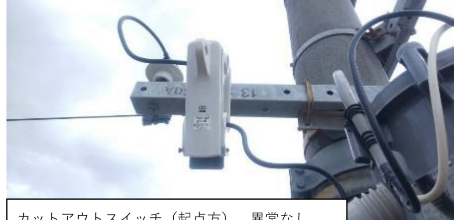
カットアウトスイッチ（起点方） 異常なし
