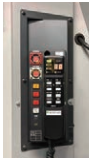
▲列車無線装置
