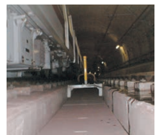
▲限界支障検知器
