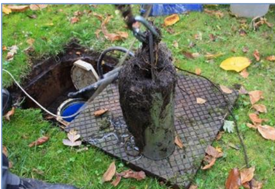
Abbildung 4-16: Pumpendummy zur Prüfung der Durchgängigkeit (hier nach der Befahrung mit Wurzelresten bedeckt).
