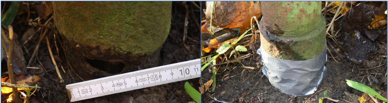
Abbildung 4-26: Dokumentation und provisorische Reparatur des beschädigten Schutzrohres an der Messstelle DO-Eving RWI 5 (059130465).
