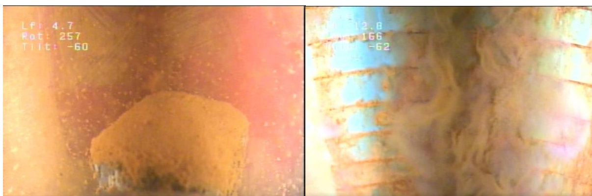
Abbildung 4-52: Fremdkörper in der Messstelle AH/7 Lasterfeld (0 60240076) (links) und Zusetzung der Filterschlitzte in der Messstelle PH 7N Roehden (100135560) (rechts).
