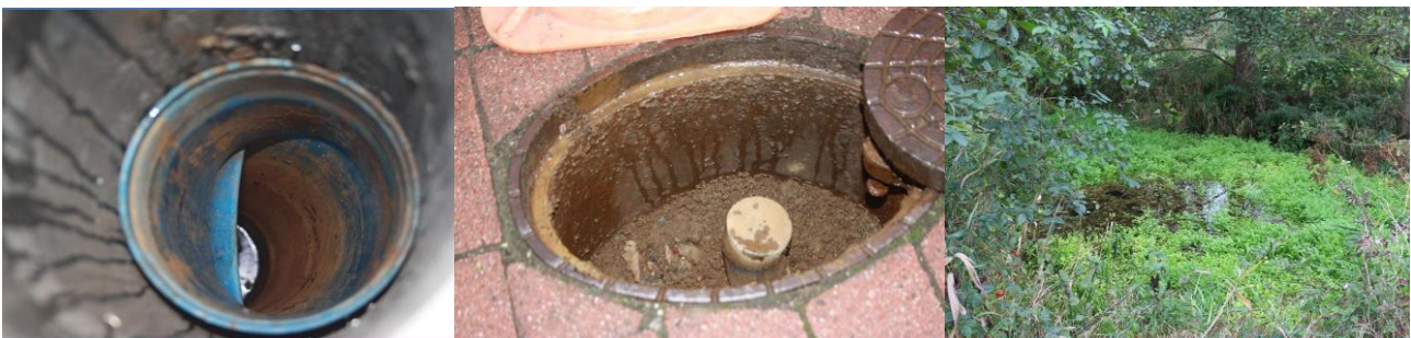
Abbildung 4-19: Exemplarische Dokumentation von baulichen Mängeln an den Messstellen (links: Knick im Rohr, Mitte: Verschmutzung der Unterflurkammer, rechts: Quellbecken und Abfluss völlig überwachsen).
