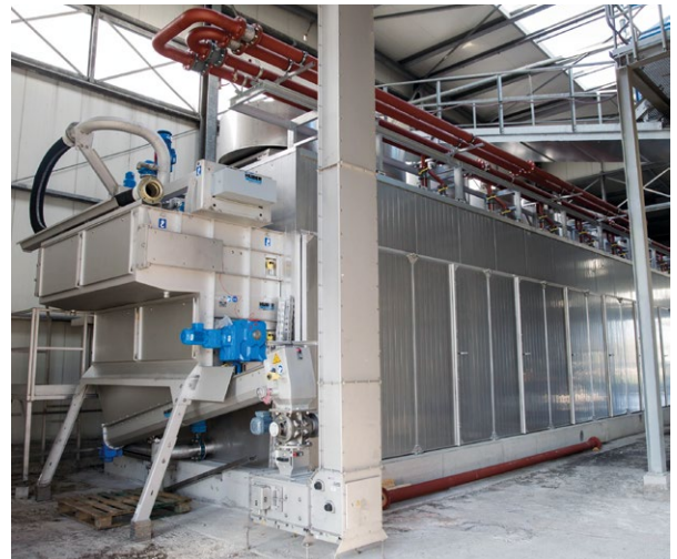
Bandtrockner in der umgebauten Klärschlamm-trocknung
