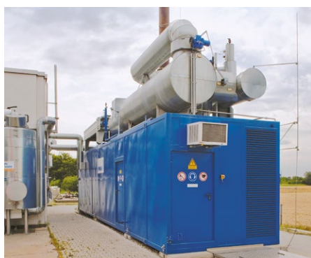
BHKW in Containerbauweise
