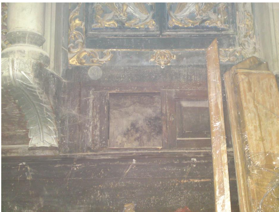
Foto 3. Nișa de depozitare de sub Nișa Torei. Se observă depozitele de praf, lipsa suportului-ornament, și depozitarea unor elemente de lemn, sprijinite de Altar
