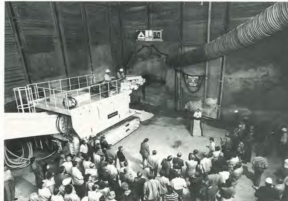
Am Rennweg: Anstich für die Tunnelröhre Richtung Rathenauplatz, rechts oben der Fräskopf der Tunnelbohrmaschine.
