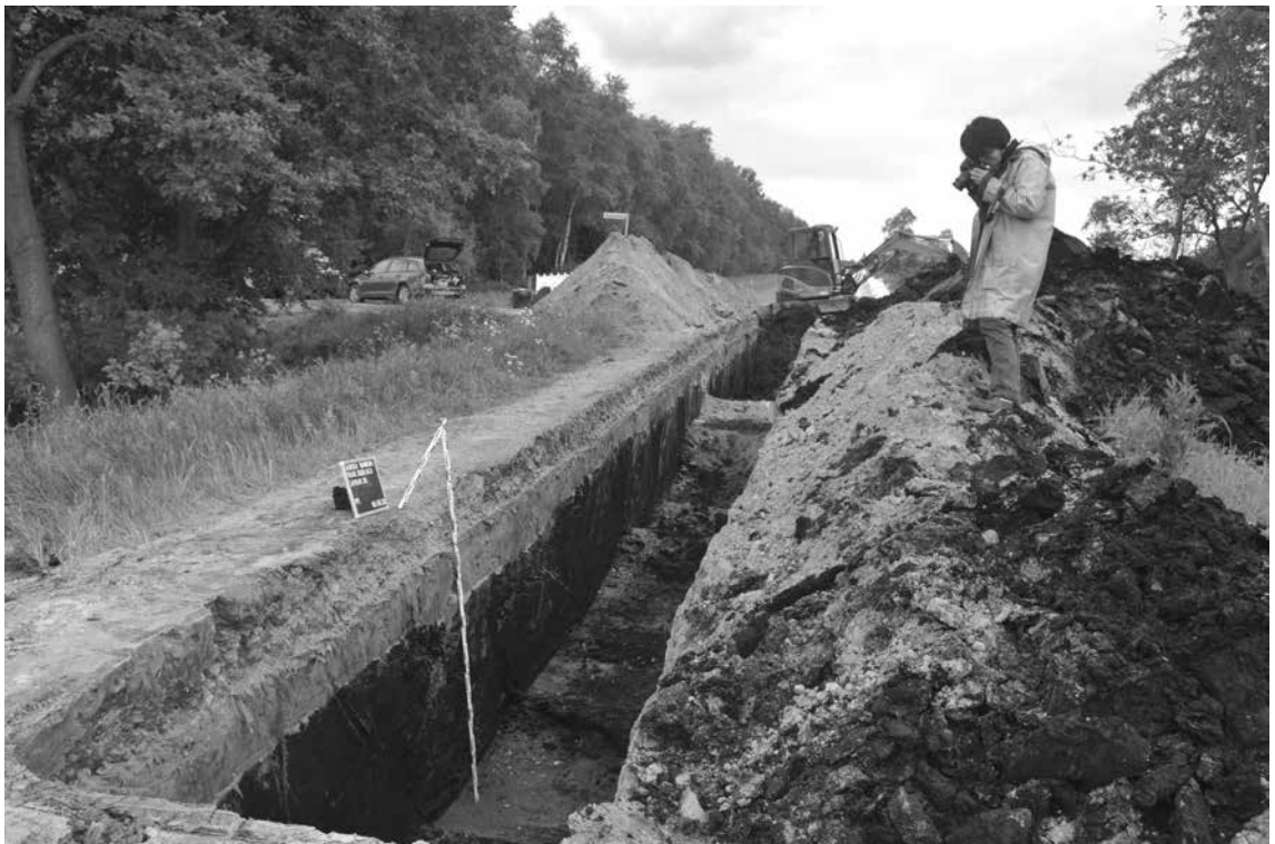
Durch den Aufbau des Feldweges ist der obere Teil des Sandweges „Sandstrahl“ Le XIV wohl schon entfernt worden. Erhalten ist nur noch der Aufbau des Moores im Liegenden (Foto: Jan F. Kegler, Ostfriesische Landschaft).
