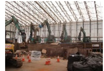
受入・分別施設 施設内(大熊町)
