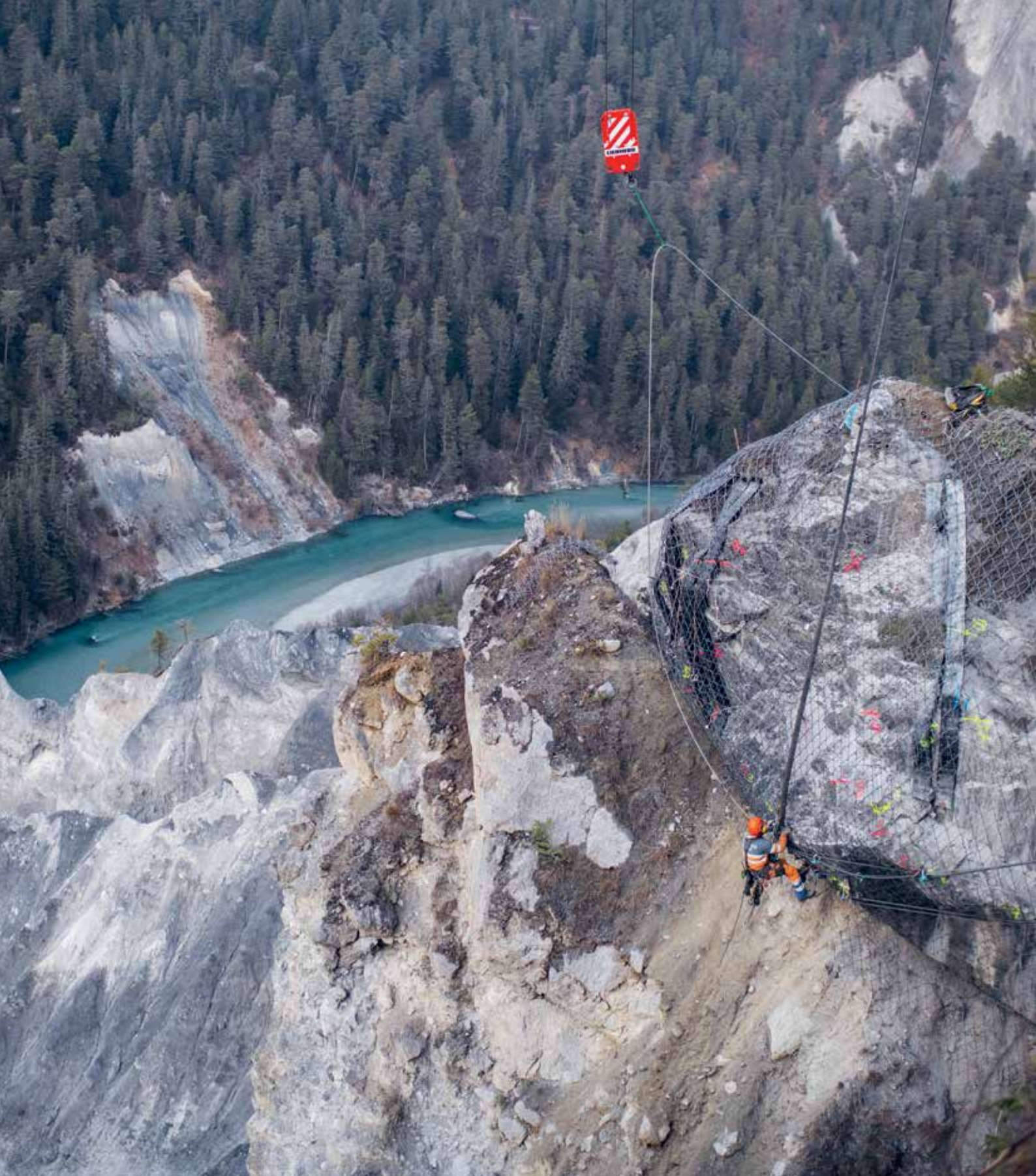
Schutzmassnahmen Felsblock Rheinschlucht
