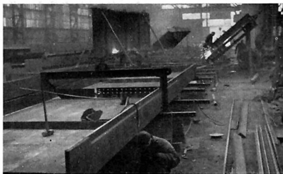
Bild 4: Fertigung der Hauptträger Fig. 4: Fabrication of main girders Fig. 4: Fabrication des poutres principales
