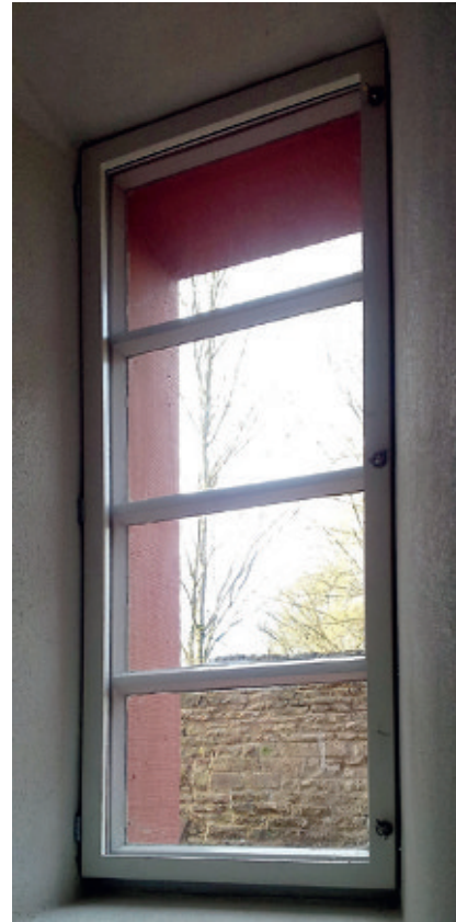
26 Einfachfenster mit Einfachverglasung mit innen aufgedoppeltem und verschraubtem Holzrahmen zur Herstellung eines Verbundfensters (Mühlhausen-Tiefenbronn, Schloss)
