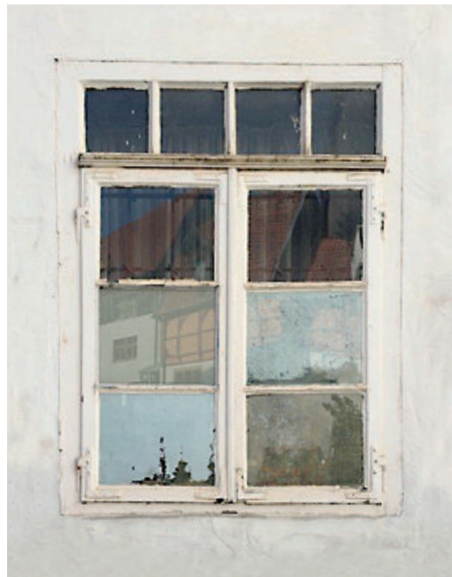
7 Zahlreiche Schäden an Rahmen und Flügeln sind die Folge von stetiger Bewitterung und unterlassener oder nicht fachgerechter Pflege. Typische Folgen sind u. a. Verspröden des Holzes und des Kitts, Abplatzen der Anstriche oder auch Glasbruch. (Bad-Salzuflen, Wohnhaus)
