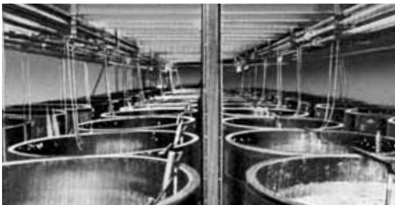
Gärkeller einer Brauerei mit so genannter stiller Kühlung.
