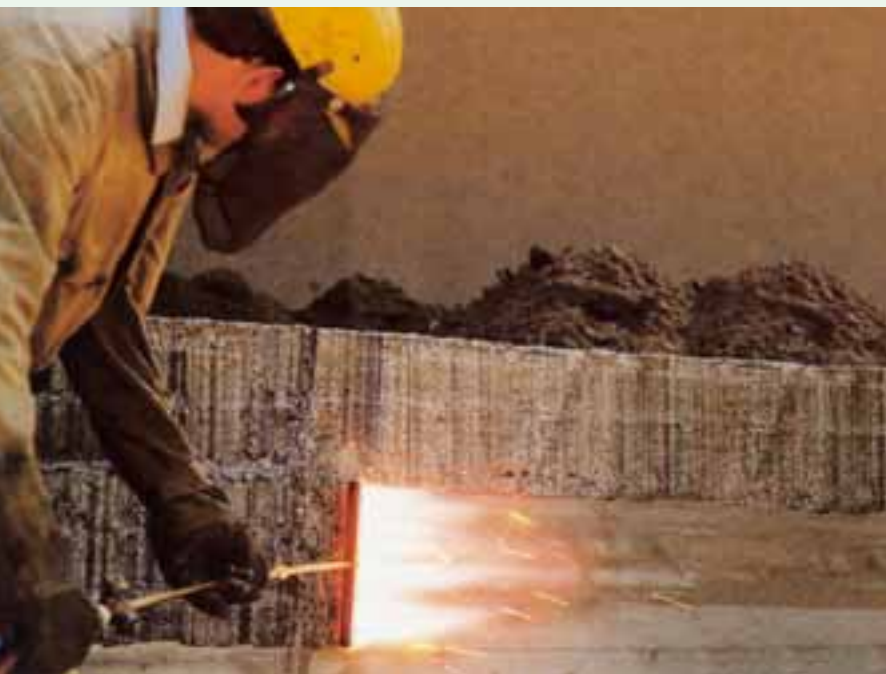
Gaseanwendung in der Bauindustrie: Flammstrahlen mit der Autogenflamme zur Oberflächenbearbeitung von Beton.
