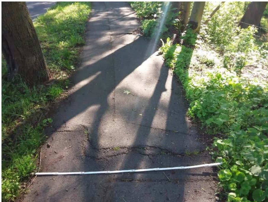
Abb. 60: Zu schmale Radverkehrsanlage (Westring) [Quelle: SVK]
