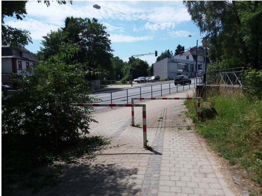
Abb. 57: Beispiel für Hindernisse im Lichtraumprofil: Sambatrasse Höhe Hauptstraße, Cronenberg [Quelle: SVK]
