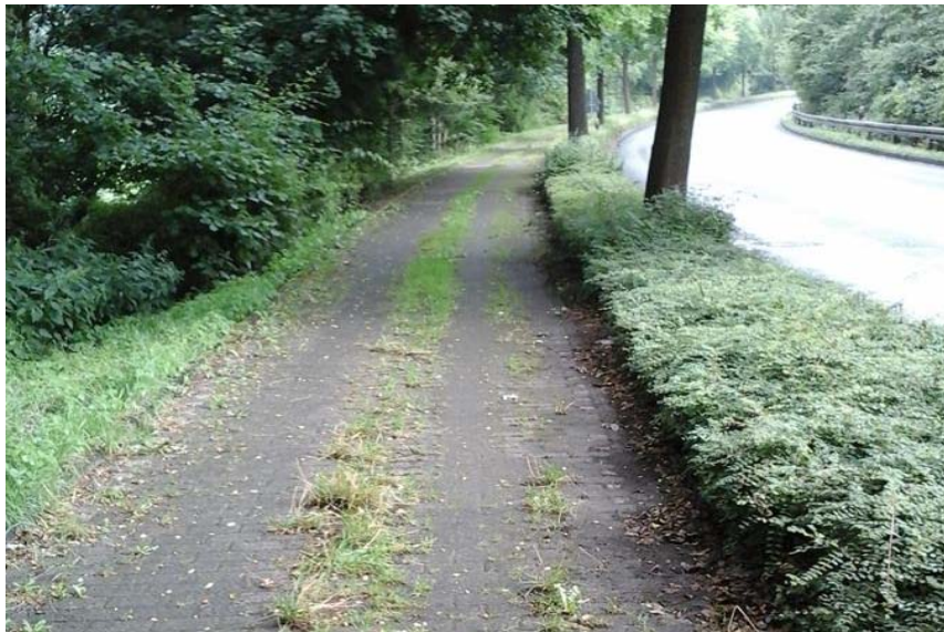
Abb. 66: Komfortmangel auf dem Radverkehrsnetz 2018 der Stadt Wuppertal (Nächstebrecker Straße) [Quelle: SVK]
