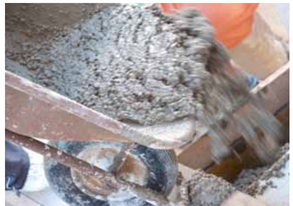
Abb. 19: Freie Fallhöhen von mehr als 1 m vermeiden.
